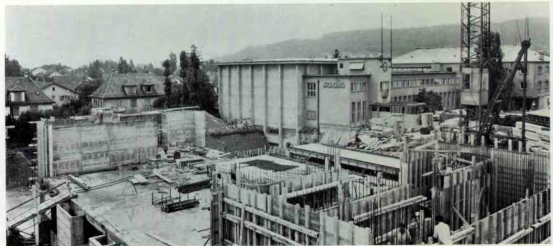
La Télévision suisse, 11 ans après son début officiel, ne loge toujours encore pas dans ses propres murs. Actuellement, les studios de Zurich (en haut), de Genève (au milieu) et de Lugano sont en construction. Mais la Radio, elle aussi, s'agrandit: le nouveau bâtiment du studio de radiodiffusion à Zurich (en bas) sera prêt pour le début de 1969
